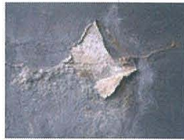
Schimmelflecken an einer Wand (Bild: Stock.XCHNG / T. Al Nakib)
